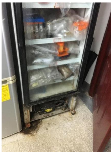
资环楼 A617—冰箱破损且轻微漏水
