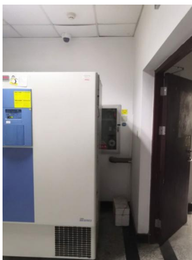
逸夫楼东侧 4 楼设备摆放遮挡消防设施
