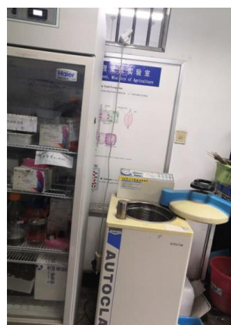
生科楼 B3002—接线板悬挂且串接使用， 负责人丁艳锋
