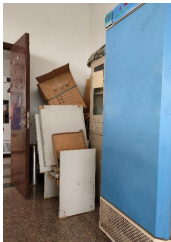
生科楼 C7000（东）楼梯口堆放杂物，阻挡消防通道
