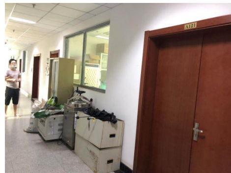
理科楼 1 楼杂物等阻挡消防通道
