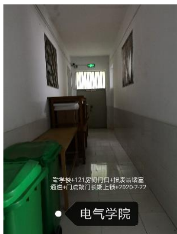
勤学楼 121 房间门口报废设备等阻挡消防通道
