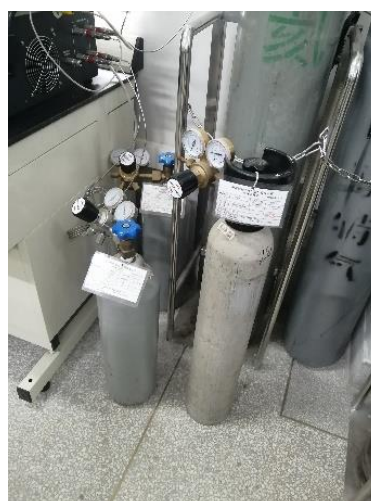
博远楼 B105—气体钢瓶未固定；
