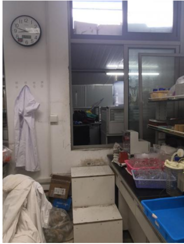
理科楼 C804—实验室违建且材料不防火 负责人华健
