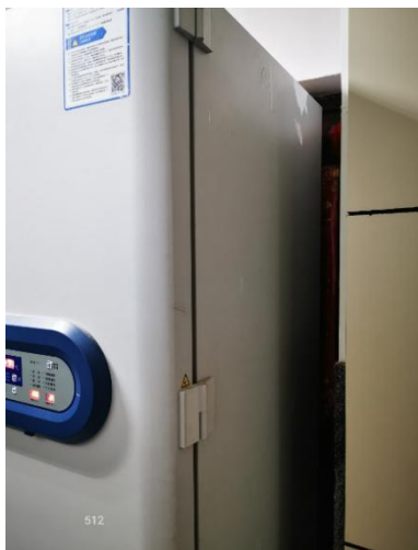
食品楼 512-实验室消防通道门被堵
