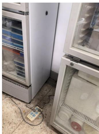
理科南楼 F614 一接线板直接放置地面使用， 负责人李艳
