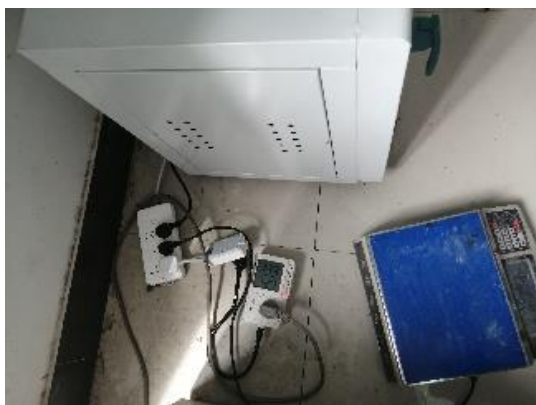
博远楼 A401—接线板直接放置于地面且串接使用
