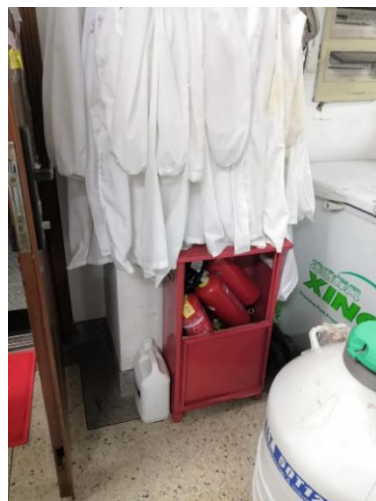
逸夫楼 3085—灭火箱内灭火器放置不规范
