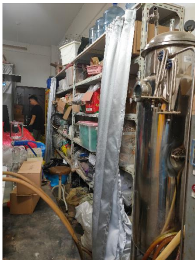
生科楼 C2024—实验室消防通道门被堵
