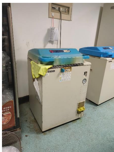
生科楼 C3010—高压灭菌锅无使用记录
