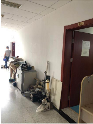
理科楼 6 楼杂物等阻挡消防通道
