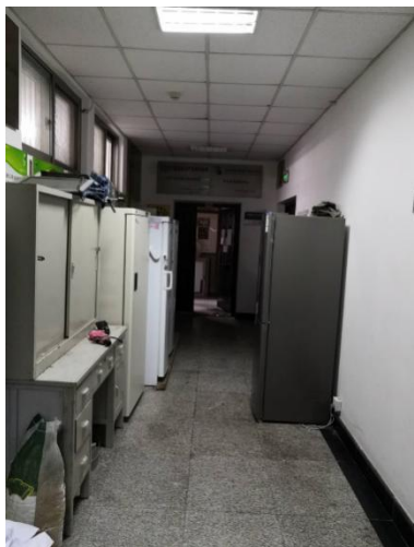
逸夫楼 3 楼 3082 室外侧楼道内设备阻挡消防通道
