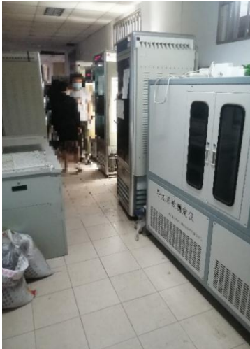
生科楼 B 座负一层一走廊两边堆放仪器设备，阻挡消防通道
