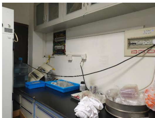
生科楼 C3011—实验室电线乱拉，强电箱被拆开
