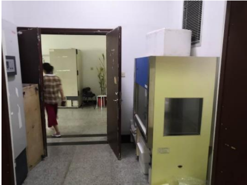
逸夫楼 3 楼楼梯口位置物资摆放阻挡消防通道
