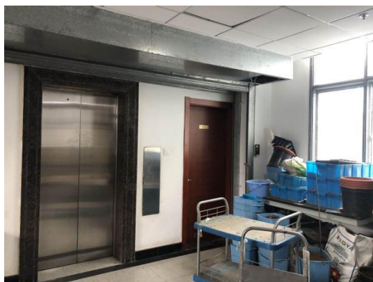
理科楼 8 楼电梯口杂物遮挡消防卷帘
