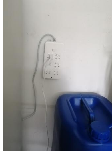
博远楼 A101—插线板悬挂使用
