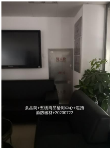
肉品检测中心五楼大厅-遮挡消防设施
