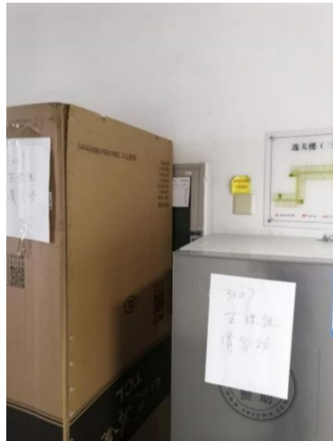
逸夫楼 3 楼东侧楼梯口位置物品摆放遮挡消防设施
