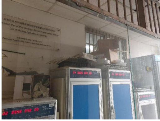
生科楼 C4024—走廊仪器上堆满杂物，阻挡消防通道
