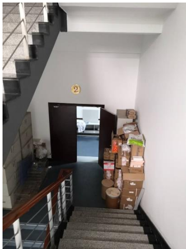
逸夫楼 2 楼最东侧楼梯口物品堆放阻挡消防通道
