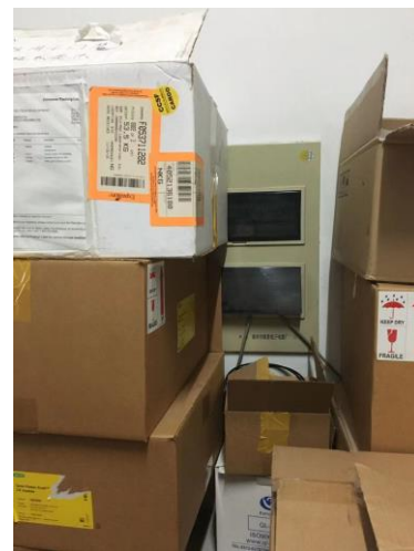
逸夫楼 4056—配电箱附近堆放大量易燃物品 负责人马喆
