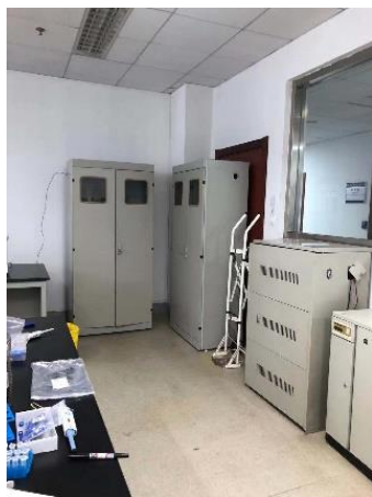
理科楼 A206—设备堵塞消防通道。负责人张芳
