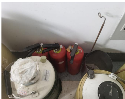
理科楼 A621-627—灭火器未配备架子，无点检记录卡 负责人毛俊融
